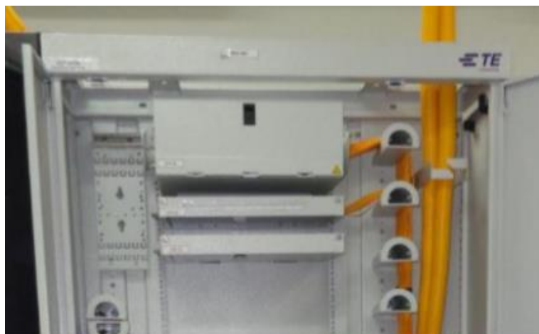
Figura 1.8. ODF de planta externa
