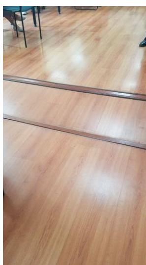
Fig. 6- Desnivel en Vicerrectorado MAD-Condición insegura
