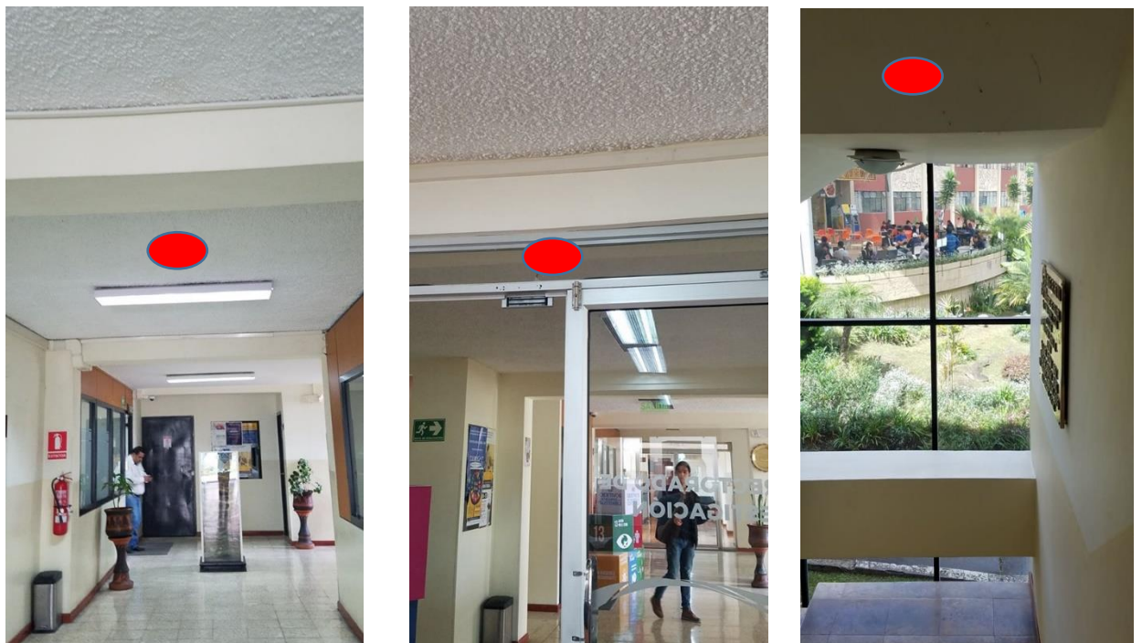
Figura 2. Luz de emergencia y señalética de evacuación
